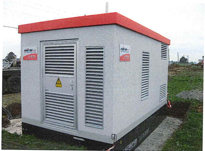
Abb. 6: Beispiel einer Trafostation
